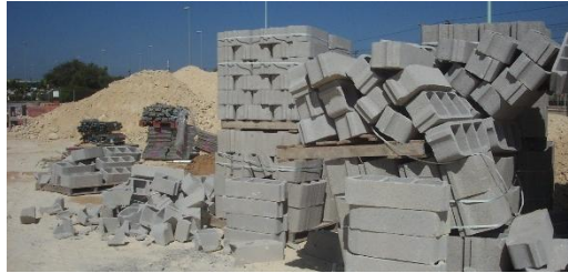
Rotura de material por acopio indebido
